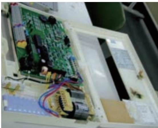
自火報設備の破損
