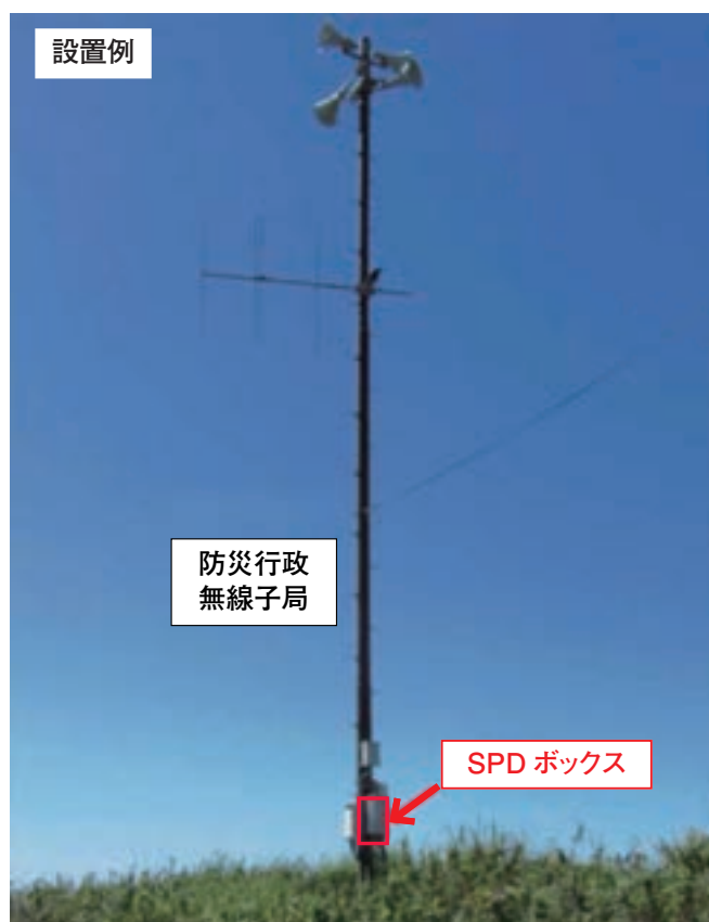
防災行政無線子局への設置例（設備全体）
