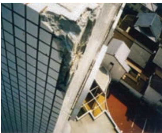
コンクリート外壁破損
