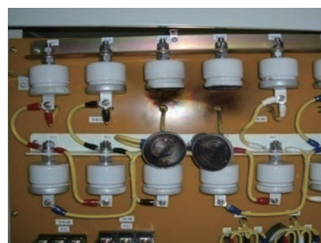
図 2-20 低圧電源用保護装置の保護素子の被害
