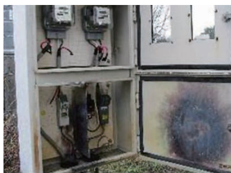
図 2-17 分電盤の被害
