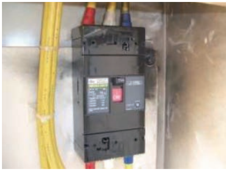
図 2-23 低圧電源引き込みブレーカーの被害
