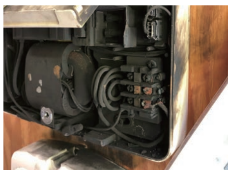
図 2-19 自動火災報知設備 (炎検知器) の被害
