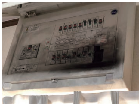
図 2-15 分電盤の被害
