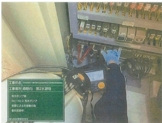
電圧異常調査
