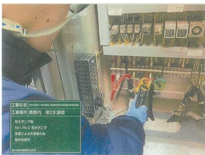
電圧異常調査
