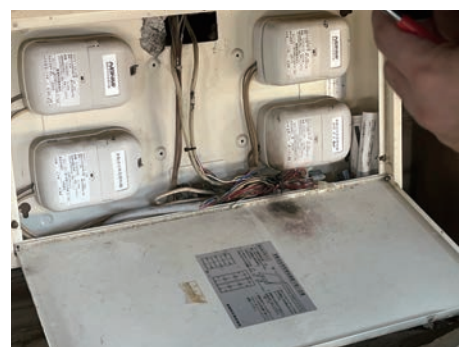
図 2-18 自動火災報知設備 (差動式分布型検知器) の被害
